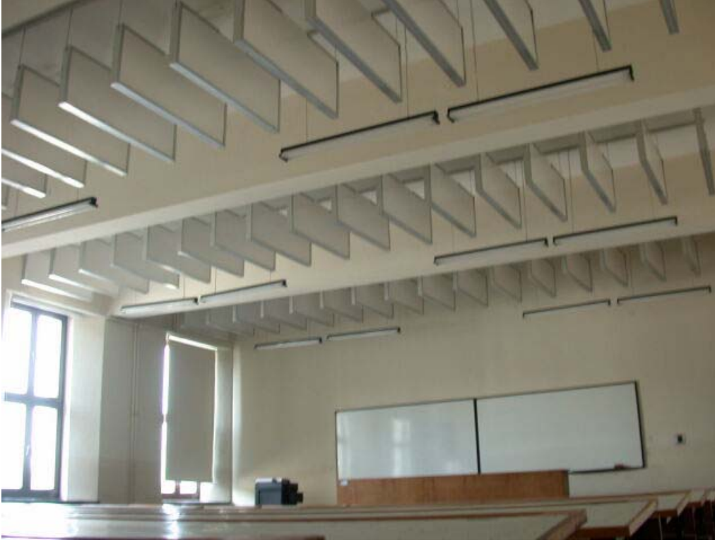
Şekil.1. Tavandan asılmak üzere tasarlanmış yutucu panellerin bir sınıfta uygulaması.
